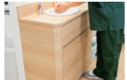
診療エリア内にあるシンクの蛇口はすべてフットペダル式になっている。手洗いは院内感染予防対策の基本だ。
